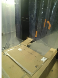
Tentative de contrôle du flux d'air
