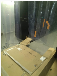
Tentative de contrôle du flux d'air
