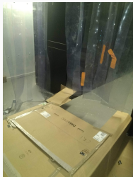
Tentative de contrôle du flux d'air
