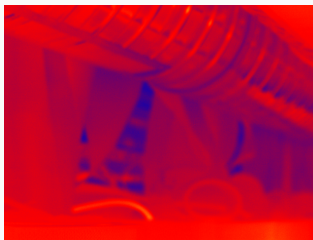
Allée chaude : perte au-dessus des baies
